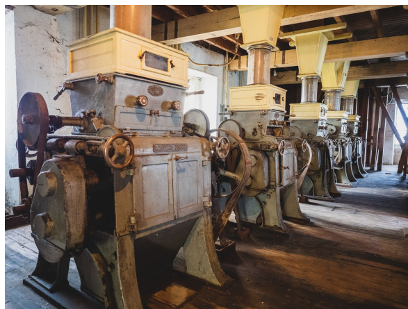
salle des machines à cylindre N1
